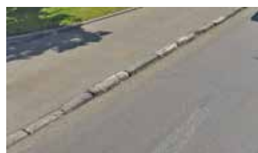
Иллюстрация 1. Состояние бордюрного камня на объекте. Источник: https://yandex.ru/maps/194/saratov
