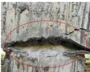
Иллюстрация 2. Рабочий шов бетонирования колонны и капители. Оголение рабочей арматуры колонны. Автор Д. В. Когтева
