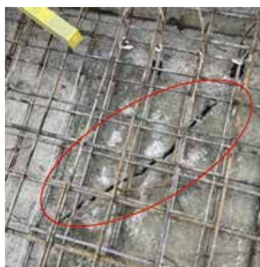
Иллюстрация 8. Плохо подготовленное основание
