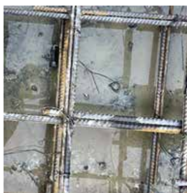
Иллюстрация 10. Плохо подготовленное основание
