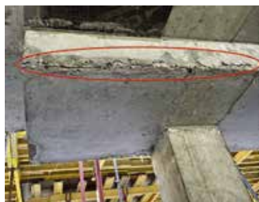
Иллюстрация 1. Плохое качество устройства опалубочных работ капители. Нарушение целостности защитного слоя арматуры капители. Автор Д. В. Когтева
