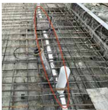
Иллюстрация 7. Плохо подготовленное основание. Недостаточный защитный слой арматуры плиты
