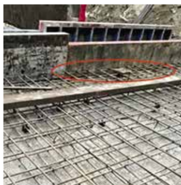
Иллюстрация 4. Плохо подготовленное основание плиты
