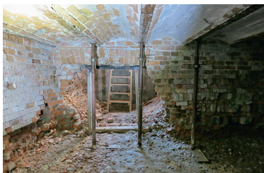
Иллюстрация 2. ОКН регионального значения «Здание бывшего магазина купцов Гавриловых». Свердловская область, г. Ирбит, ул. Красноармейская, д. 15. Перекрытие над подвалом выполнено в 1890-е гг. Шаг балок 800...900 мм. Толщина свода «в полкирпича» — 120 мм. Стрела свода 120 мм. Стальные балки перекрытия сечением из прокатных рельсов типа Р33. Пролет 4,8 м. Фото С. В. Кудрявцева. 2024 г.
