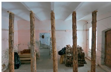
Иллюстрация 1. ОКН регионального значения «Особняк Д. А. Бахарева». Свердловская область, с. Байкалово. Перекрытие над первым этажом здания выполнено в 1896 г. Деревянные страховочные подпорки под стальными балками перекрытия. Пролет 5,6 м. Фото С. В. Кудрявцева. 2023 г.
